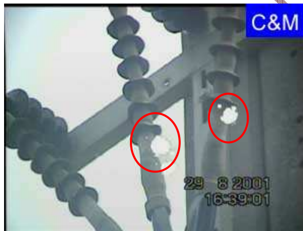
شکل - ۷: تصویر کرونای ناشی از تخلیه های جزئی در سرکابل ۲۰ کیلوولت معیوب
