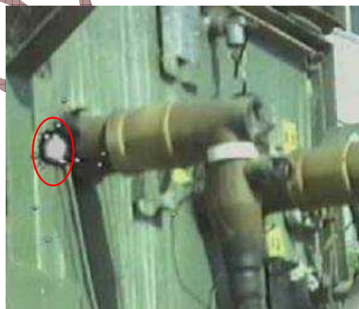
شکل ۵- تصویرکروناي ناشی از زانوئی (Elbow) یک ترانس توزیع (سمت فشار قوی)
